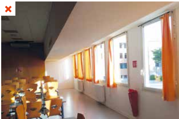
Rideaux intérieurs qui n'empêchent pas les surchauffes d'une salle de réunion. ©AQC
