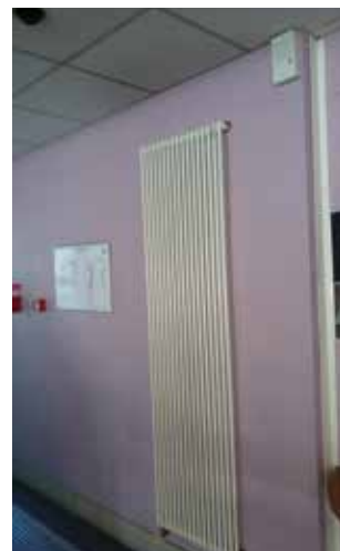
Dans cette zone bénéficiant d'apports solaires en mi-saison, des radiateurs à faible inertie ont été choisis pour leur réactivité. ©AQC
