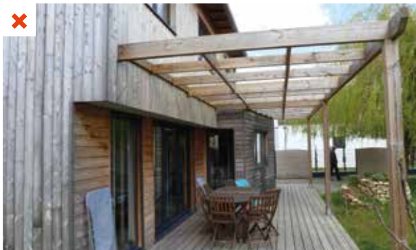
Protection solaire végétale prévue en conception mais jamais plantée pour des raisons financières. ©AQC
