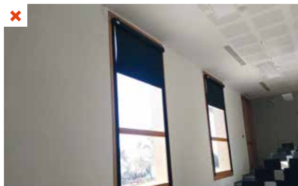
Rideaux roulants intérieurs de couleur noire qui n'empêchent pas les surchauffes d'un amphithéâtre exposé est. ©AQC
