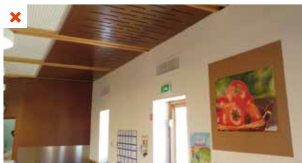
Dans cette cantine, les entrées d'air en imposte pour la ventilation naturelle sont sous dimensionnées pour le rafraîchissement nocturne. ©AQC
