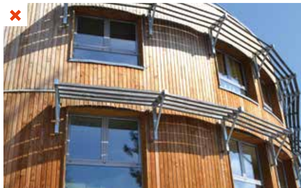
Protections solaires sous-dimensionnées. ©AQC
