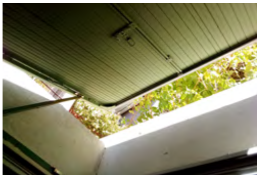
Volets à projection dans un logement collectif © EnvirobatBDM
