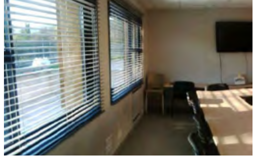
Les stores intérieurs créent en été un inconfort thermique © EnvirobatBDM
