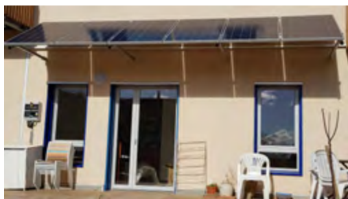
Panneaux photovoltaïques en protection solaire Photo prise le 18 janvier © EnvirobatBDM
