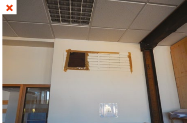
Dans cette école, une partie de la grille d'insufflation a été obturée car un courant d'air gênant était ressenti par les occupants. ©AQC
