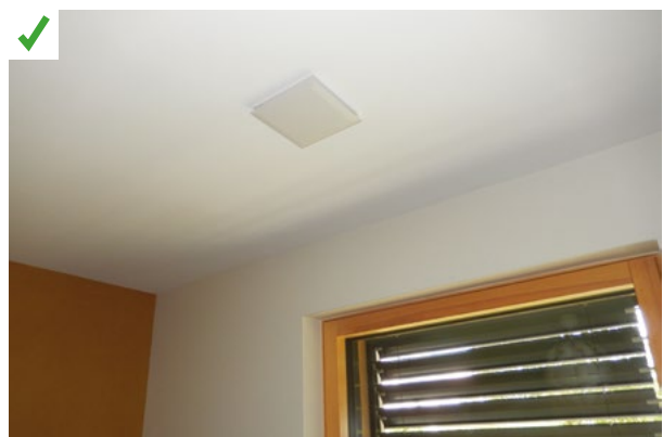
Présence d'une bouche à effet coanda dans une chambre. Le flux d'air est dirigé le long du plafond et aucune gêne n'est ressentie par les usagers. ©AQC
