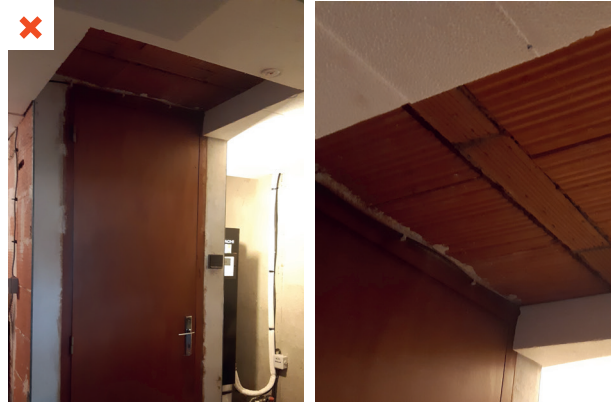
L'isolation du plancher haut du garage s'arrête au niveau de la zone de débattement de la porte d'accès à l'étage de la maison. ⚠
