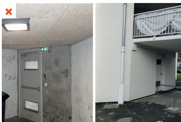
L'isolation du plancher bas de ce local en RDC s'arrête au droit du mur périphérique isolé par l'extérieur jusqu'en pied de façade. ©AQC
