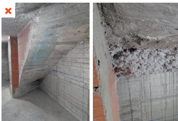
La cage d'escalier menant aux caves de cet immeuble n'a pas été isolée en même temps que la sous-face du plancher bas, ce qui entraîne une augmentation des déperditions des logements vers les circulations. ©AQC
