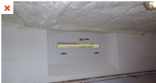
Dans cette cave semi-enterrée dont le plafond a été isolé, les soupiroux ont été remplacés par des fenêtres, empêchant de fait la ventilation naturelle lorsque celles-ci sont fermées. ©AQC
