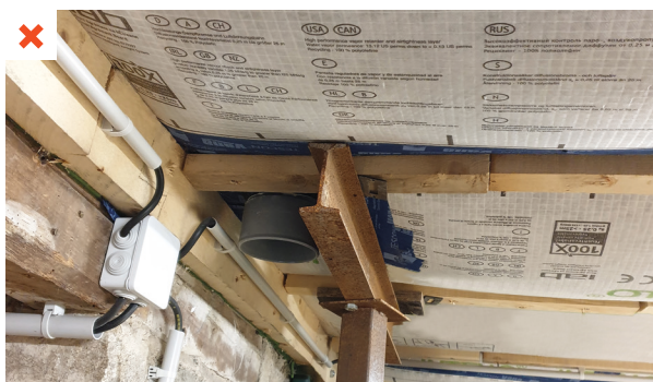
La membrane frein vapeur hydrovariable est positionnée du côté non chauffé de la paroi (isolation d'un plancher bois sur cave par insufflation de ouate de cellulose entre solives). ©AQC
