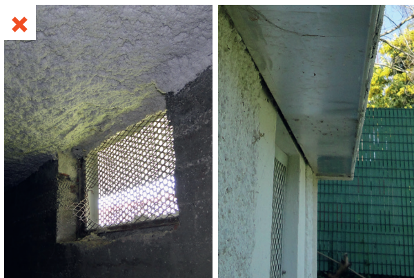
L'isolation du plancher bas et celle des murs extérieurs s'arrêtent toutes deux au-dessus des soupiraux, ce qui génère un important pont thermique juste en dessous du nez de dalle du plancher bas. ©AQC
