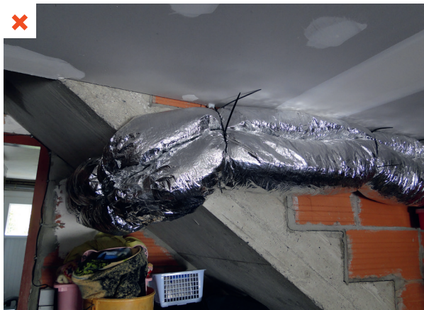
L'escalier intérieur de la maison traversant le garage n'a pas été pris en compte lors de l'isolation du plafond du garage. ©AQC
