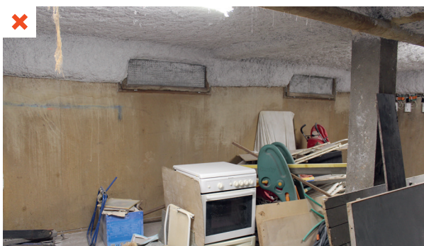
Les soupiroux de ce sous-sol ont été obstrués par de l'isolant projeté lors de l'opération d'isolation du plancher bas. ©AQC
