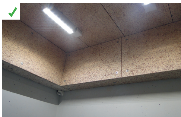
L'isolation du plancher bas est renforcée par une isolation en retombée de murs, afin de minimiser le pont thermique de liaison avec les murs extérieurs isolés par l'extérieur. ©AQC
