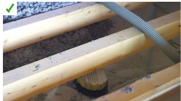
Un capot de protection adapté recouvre le spot encastré. Le traitement de l'étanchéité à l'air englobe le dispositif. ©AQQC
