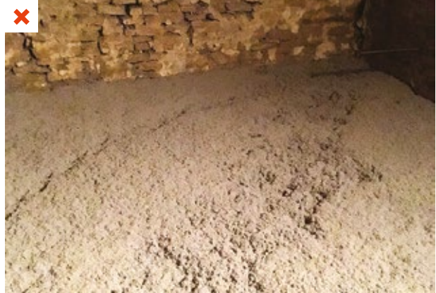
L'isolant a été endommagé suite à l'inspection du comble par le propriétaire. ©AQC
