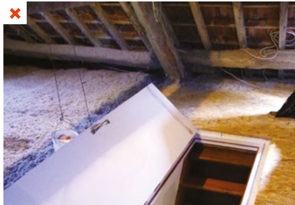
Trappe d'accès aux combles non-isolante. ©AQC
