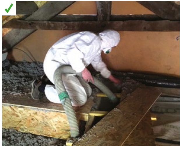
Mise en place d'un cheminement technique pour accéder au groupe de ventilation. L'intérieur du caisson est isolé et une lame d'air est maintenue entre l'isolant et le haut du coffrage. ©AQC
