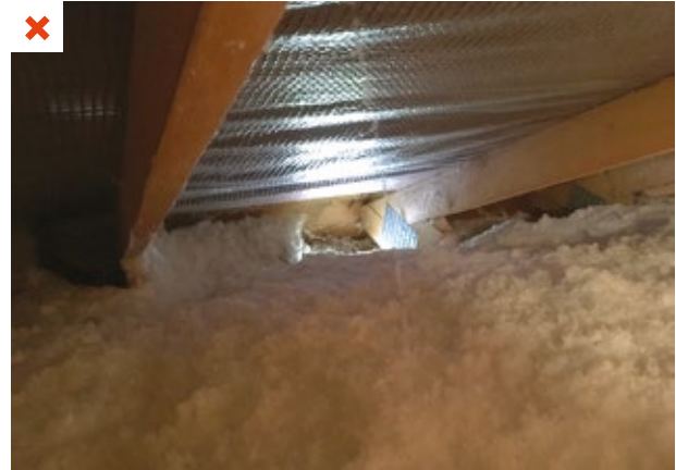
Cette entrée d'air, improvisée pour pallier l'absence de ventilation suite à l'isolation du comble, n'est ni adaptée, ni pérenne. L'isolant non retenu risque de l'obstruer à terme. ©AQC
