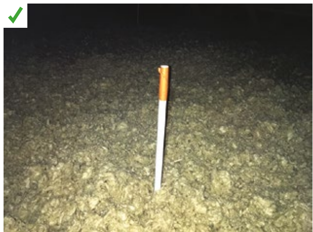
Cette borne permet de repérer un boîtier électrique étanche qui n'a pas pu être déplacé. ©AQC
