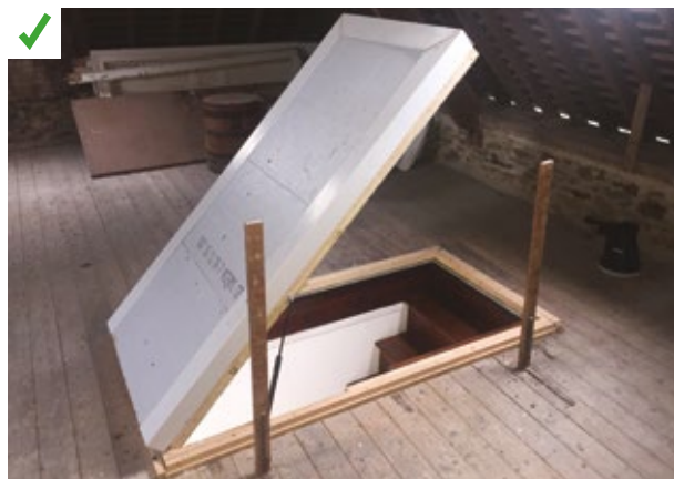
Mise en place d'une trappe d'accès aux combles isolée. Un coffrage sera réalisé autour pour contenir l'isolant soufflé. ©AQC
