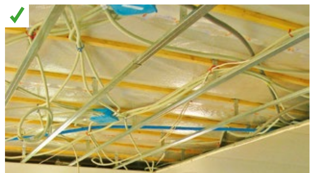
Les spots encastrés sont déplacés dans le plénum technique réalisé sous la membrane d'étanchéité à l'air sous le plancher nouvellement isolé. La hauteur de ce type d'espace doit être supérieure à 10 centimètres pour pouvoir dissiper la chaleur produite par les éclairages. ©AQQC
