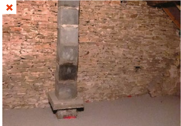
En l'absence de coffrage, l'isolant biosourcé en vrac est au contact direct du conduit de cheminée. Cette configuration n'est pas réglementaire et peut être à l'origine d'un départ de feu. ©AQC
