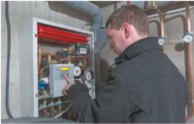
Armoire de régulation d'une chaufferie.
