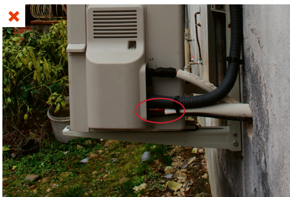
L'isolation du réseau frigorifique est incomplète et s'interrompt avant d'arriver au droit de l'unité extérieure. En outre, la traversée du mur par les réseaux n'est pas étanche. ©AQC
