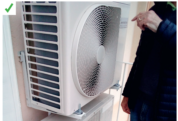
Le système à éléments séparés ou bibloc a été choisi pour éviter les nuisances sonores générées par le compresseur et le ventilateur. Ces deux éléments sont à l'extérieur. ©AQC
