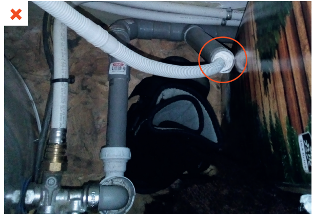
Le tuyau d'évacuation des condensats est relié au réseau d'évacuation, mais ne dispose pas de siphon. ©AQC
