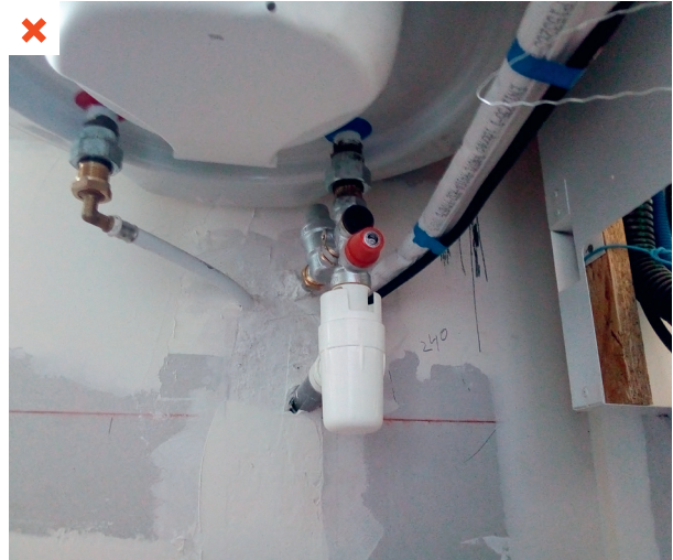
Le propriétaire n'a pas été averti de la recommandation d'entretien du groupe de sécurité une fois par mois. ©AQC
