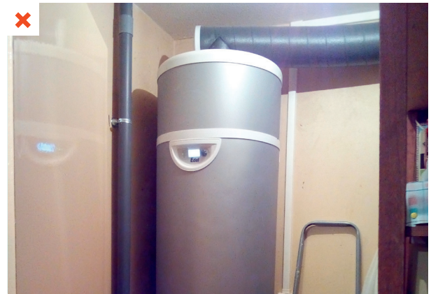
Le CET situé à proximité d'une chambre perturbe le sommeil des occupants. La cloison séparative et la traversée par la conduite aéraulique ne sont pas isolées acoustiquement. ©AQC
